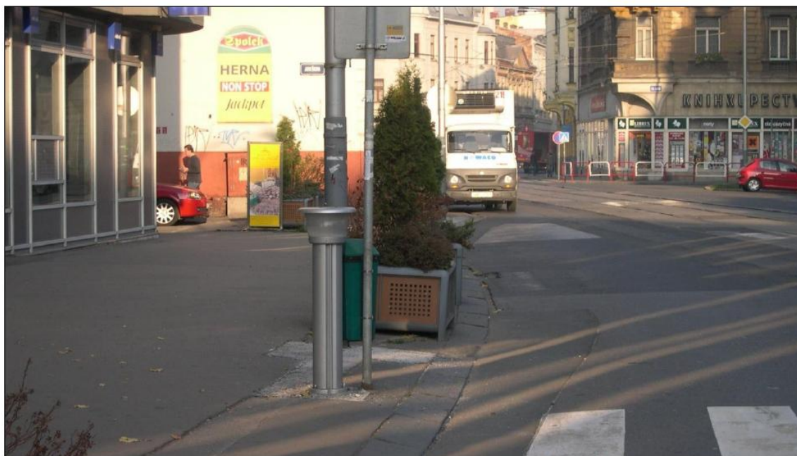
Obr. 13 Speciální osvětlení přechodu pro chodce, svítidlo typu VEGA BOLLARD
