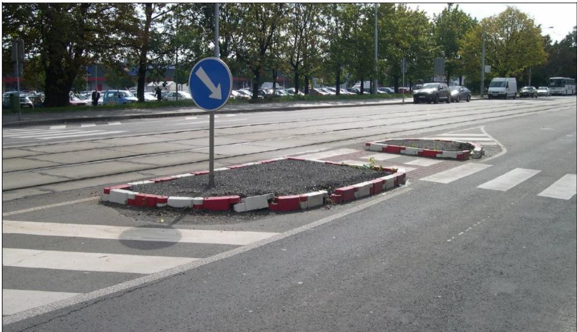
Obr. 4 Poškození dělicího ochranného ostrůvku v provedení z plastových obrubníků mezi tramvajovým pásem a vozovkou
